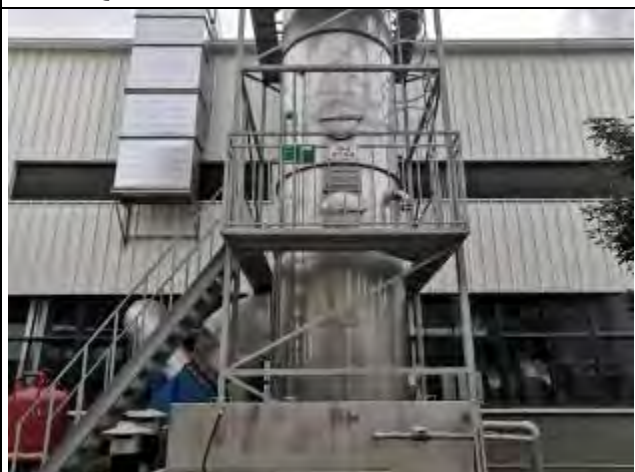
FQ-18102-24 总 VOCs 排放口 (远)
