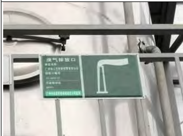
FQ-18102-27 总 VOCs 排放口 (近)
