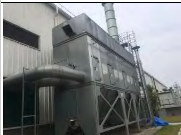
废气处理设施
