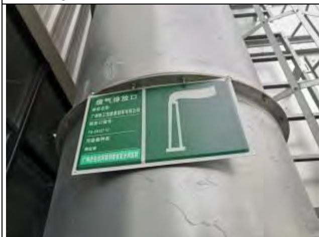
FQ-18102-57 颗粒物排放口 (近)
