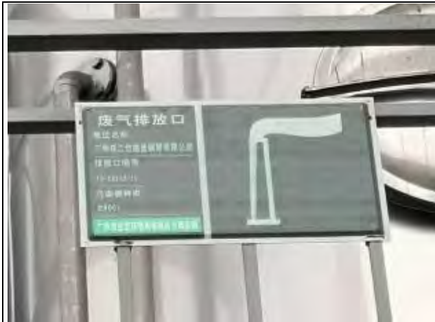
FQ-18102-16 总 VOCs 排放口 (近)
