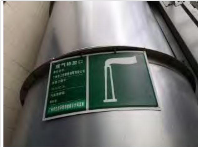
FQ-18102-34 颗粒物排放口（近）
