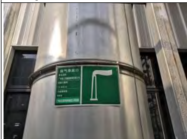
FQ-18102-33 颗粒物排放口 (近)
