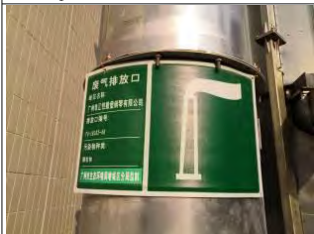
FQ-18102-48 颗粒物排放口（近）
