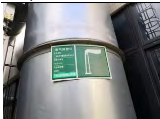
FQ-18102-47 颗粒物排放口（近）
