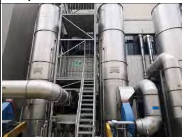
FQ-18102-11 总 VOCs 排放口 (远)
