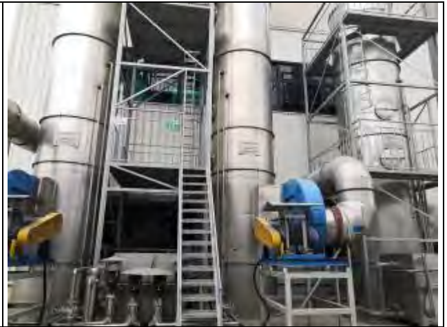
FQ-18102-13 总 VOCs 排放口 (远)
