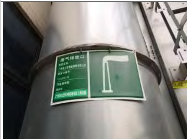
FQ-18102-35 颗粒物排放口（近）
