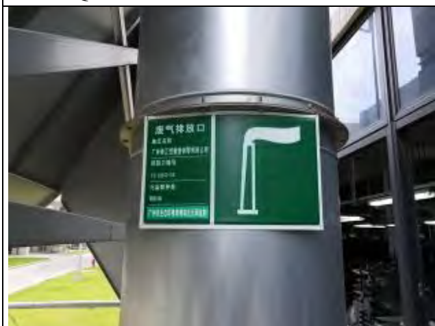
FQ-18102-50 颗粒物排放口（近）
