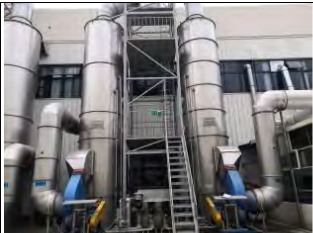
FQ-18102-10 总 VOCs 排放口 (远)
