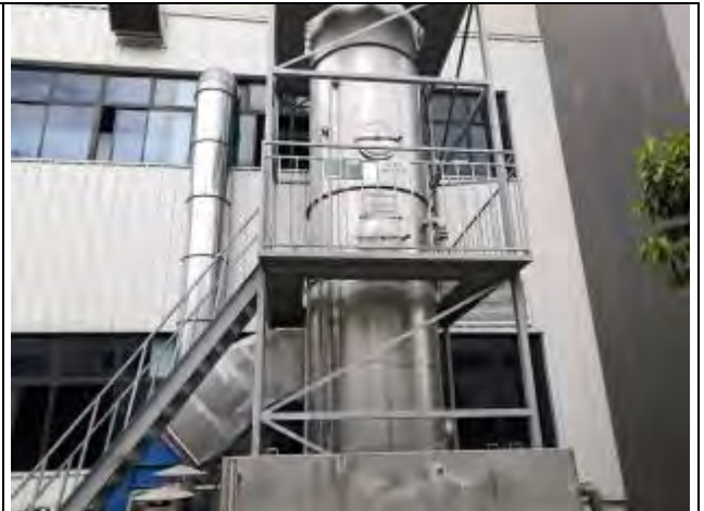
FQ-18102-16 总 VOCs 排放口 (远)
