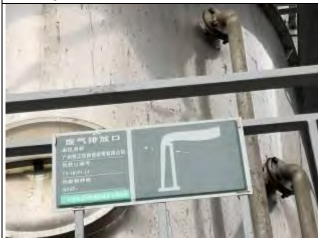
FQ-18102-14 总 VOCs 排放口 (近)
