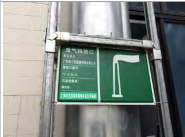
FQ-18102-41 颗粒物排放口（近）
