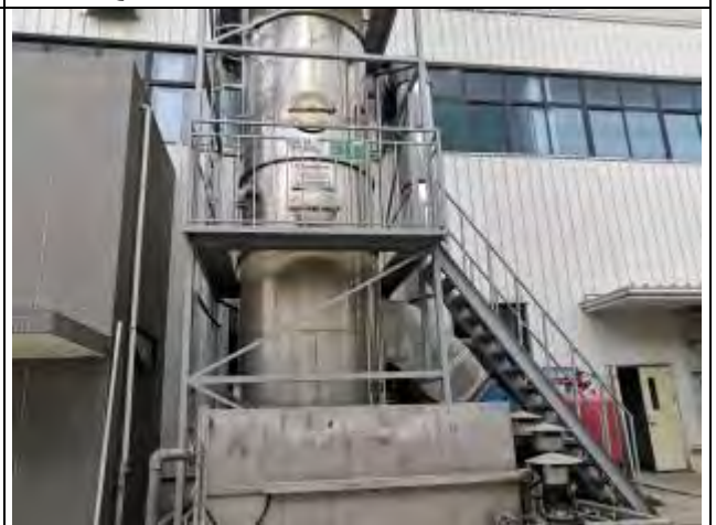
FQ-18102-14 总 VOCs 排放口 (远)
