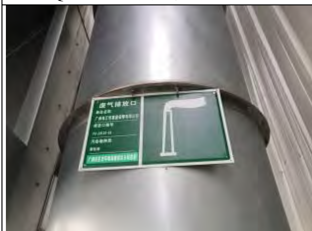
FQ-18102-56 颗粒物排放口 (近)
