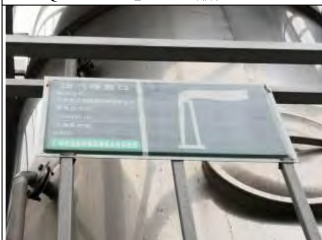
FQ-18102-12 总 VOCs 排放口 (近)
