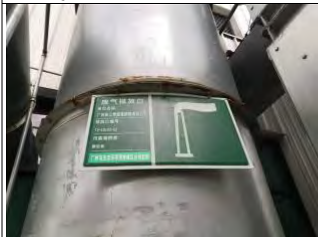
FQ-18102-62 颗粒物排放口 (近)
