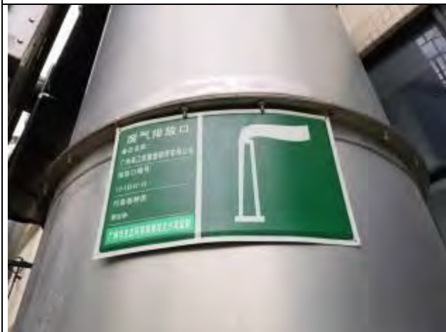
FQ-18102-36 颗粒物排放口（近）
