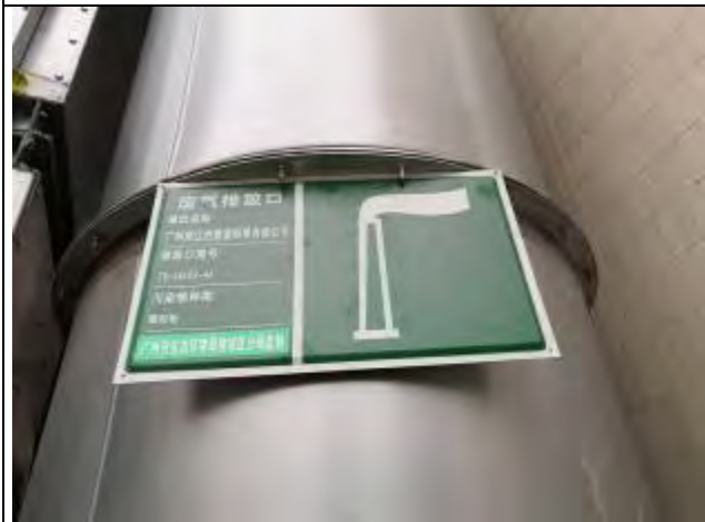
FQ-18102-44 颗粒物排放口（近）
