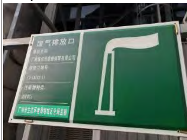
FQ-18102-17 总 VOCs 排放口 (近)
