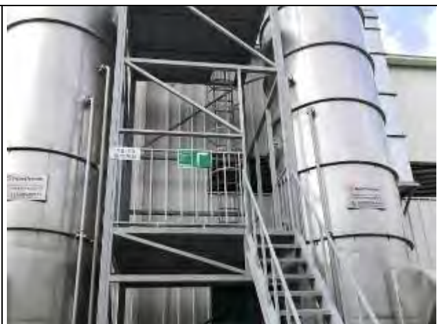
FQ-18102-28 总 VOCs 排放口 (远)
