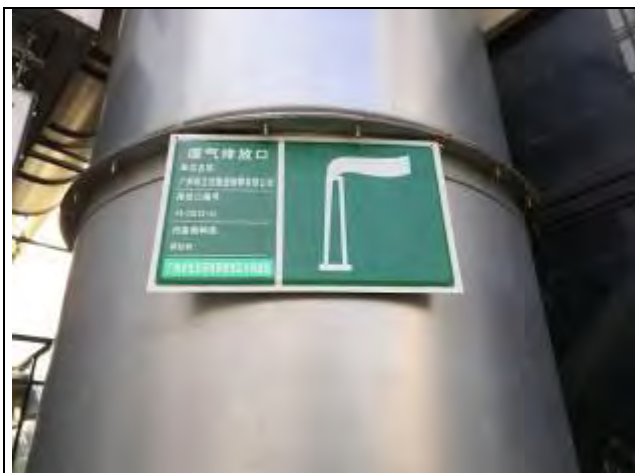
FQ-18102-55 颗粒物排放口 (近)
