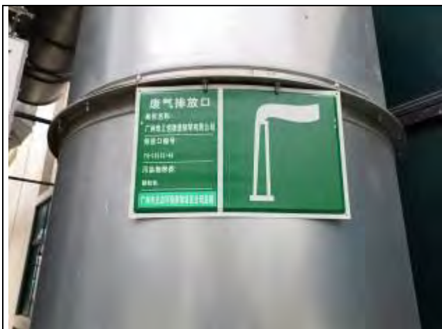
FQ-18102-46 颗粒物排放口（近）
