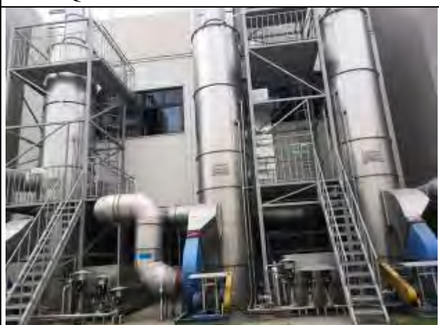
FQ-18102-9 总 VOCs 排放口 (远)
