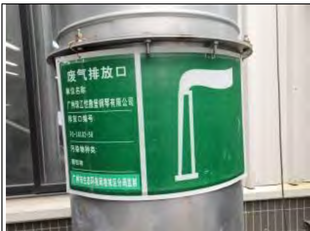
FQ-18102-58 颗粒物排放口（近）
