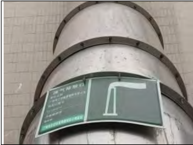
FQ-18102-52 颗粒物排放口 (近)
