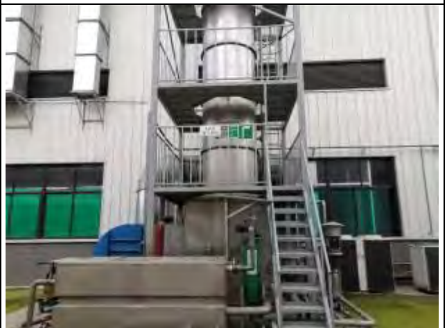
FQ-18102-26 总 VOCs 排放口 (远)
