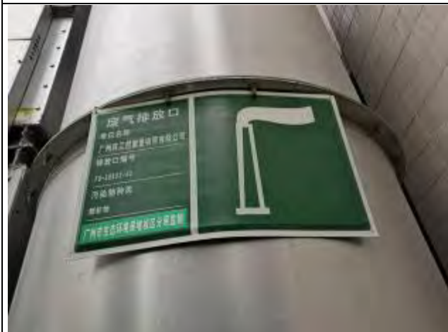
FQ-18102-42 颗粒物排放口（近）
