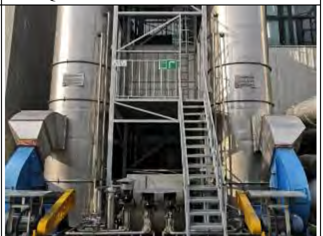
FQ-18102-17 总 VOCs 排放口 (远)
