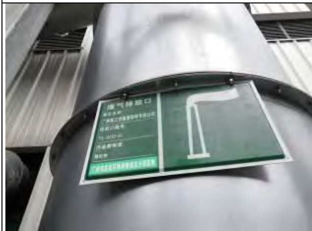
FQ-18102-63 颗粒物排放口 (近)
