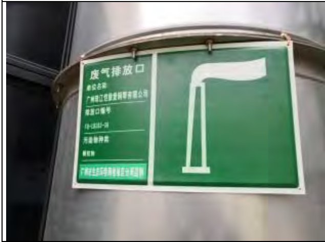
FQ-18102-38 颗粒物排放口（近）
