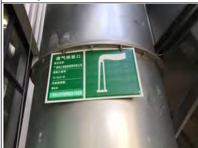
FQ-18102-60 颗粒物排放口（近）
