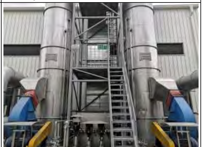
FQ-18102-21 总 VOCs 排放口 (远)
