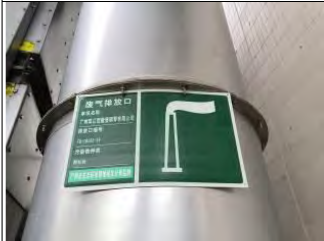
FQ-18102-39 颗粒物排放口（近）
