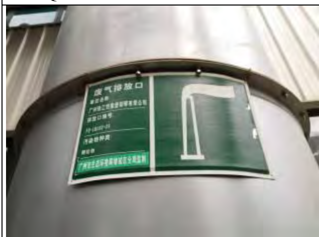
FQ-18102-29 颗粒物排放口 (近)
