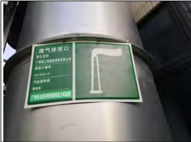
FQ-18102-43 颗粒物排放口（近）
