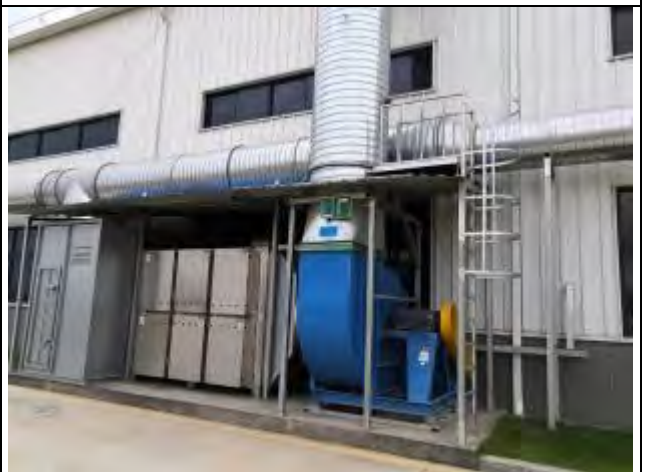
FQ-18102-5 总 VOCs 排放口（远）
