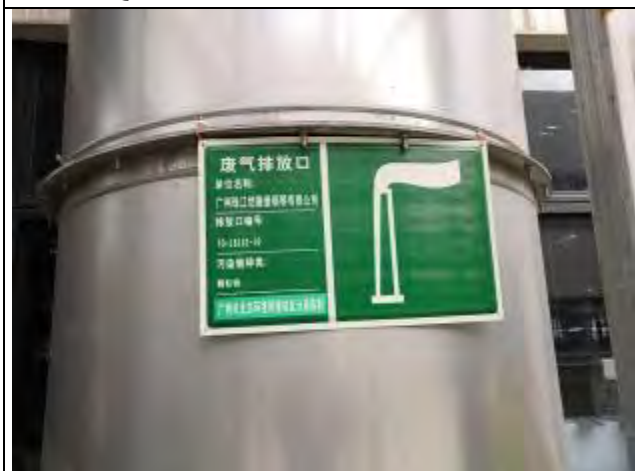
FQ-18102-30 颗粒物排放口 (近)
