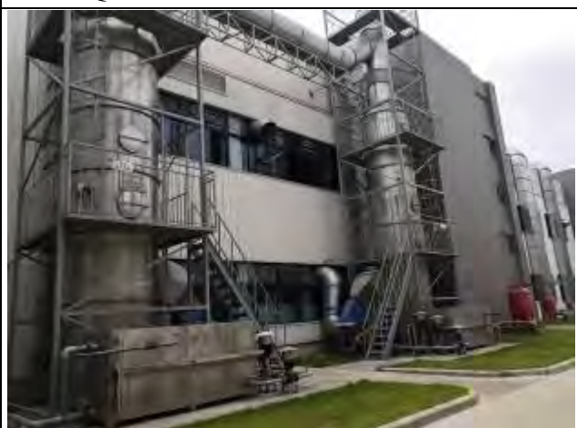
FQ-18102-8 总 VOCs 排放口 (远)
