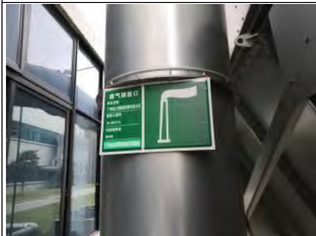
FQ-18102-54 颗粒物排放口 (近)
