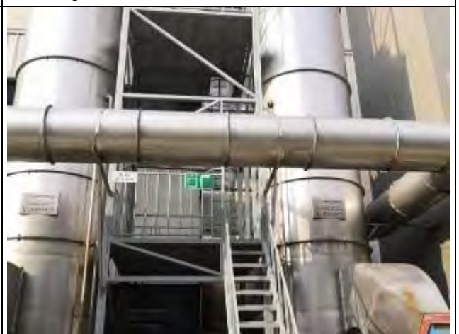
FQ-18102-18 总 VOCs 排放口 (远)
