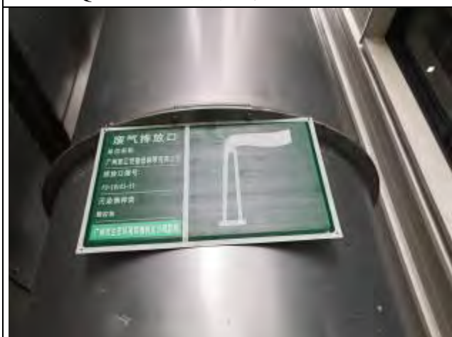
FQ-18102-59 颗粒物排放口（近）
