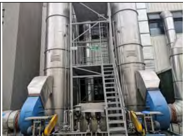
FQ-18102-7 总 VOCs 排放口 (远)
