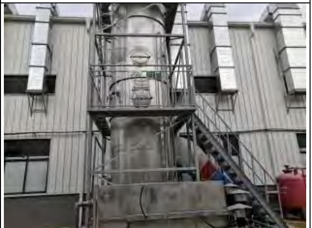
FQ-18102-27 总 VOCs 排放口 (远)
