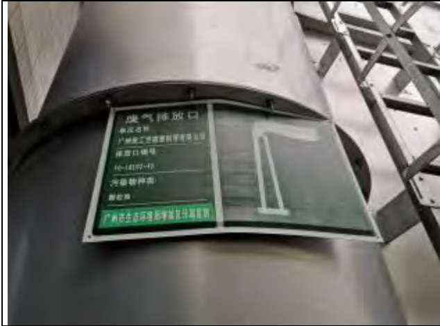
FQ-18102-40 颗粒物排放口（近）
