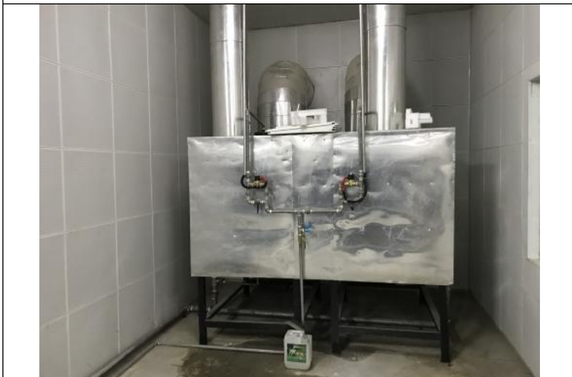
发电机房水喷淋装置
