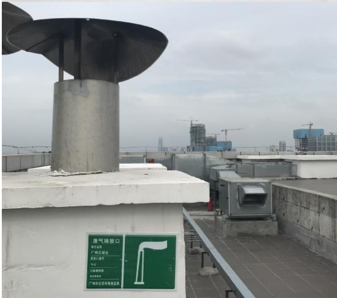
气-02 发电机尾气排放口
