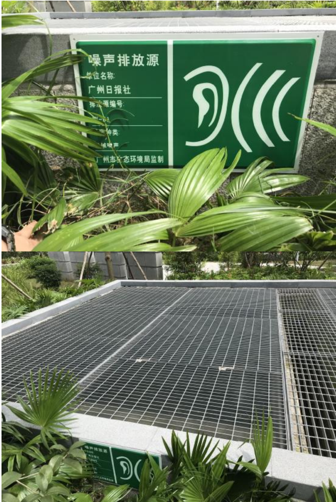
声-01 发电机房首层排风口
