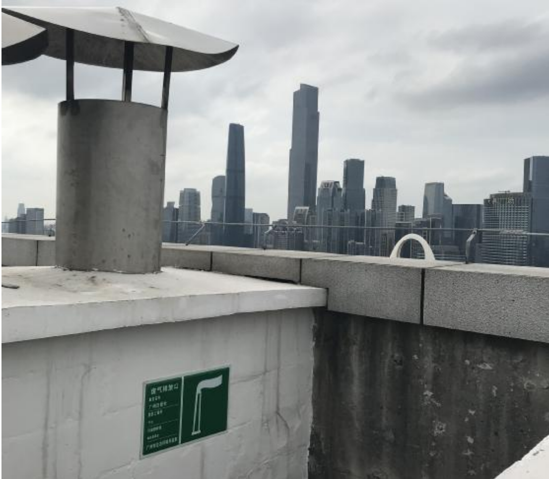
气-01 发电机尾气排放口
