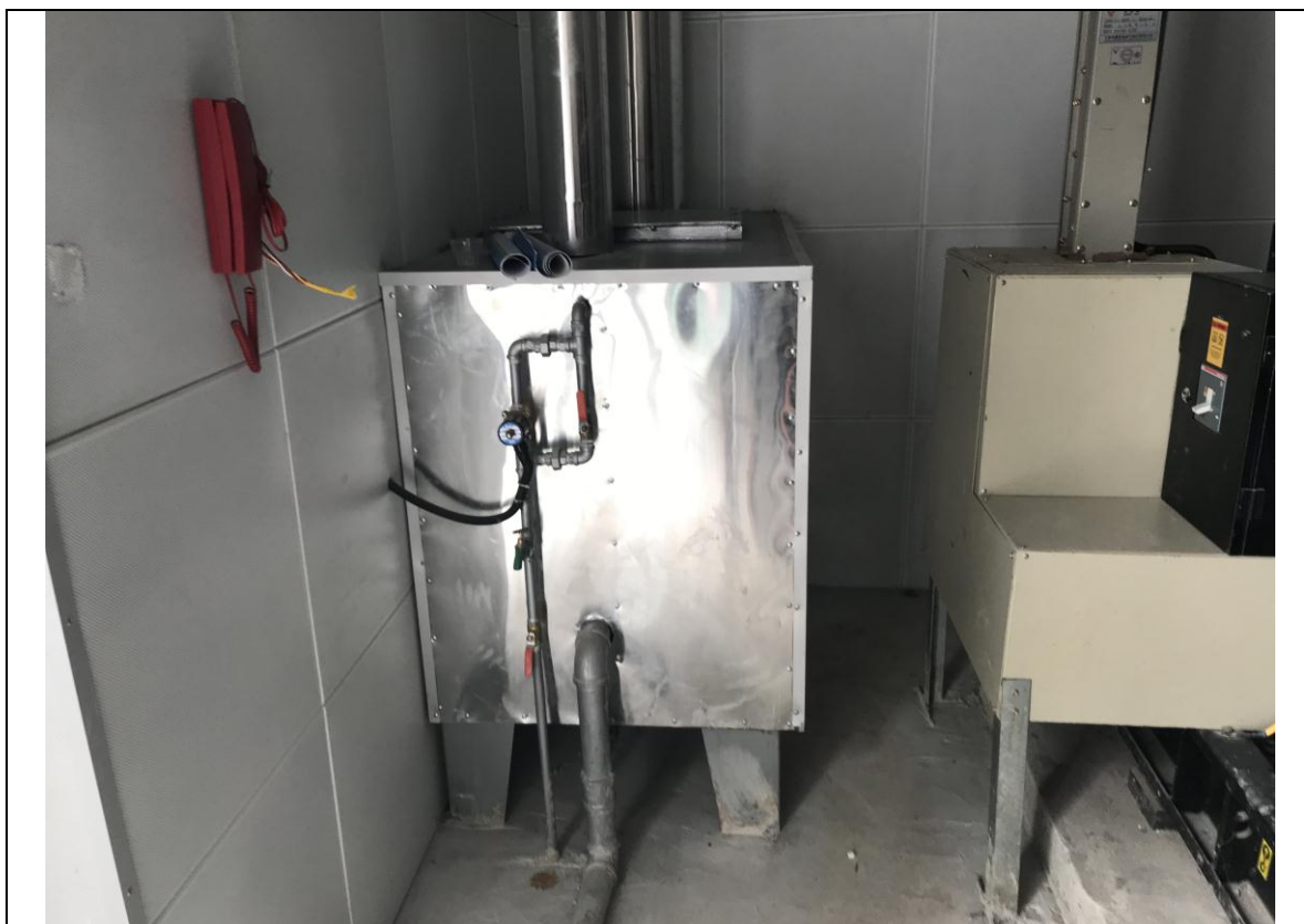
发电机水喷淋设施
