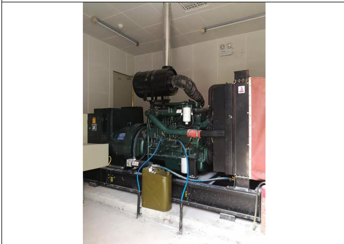
发电机房吸声墙及排烟管
