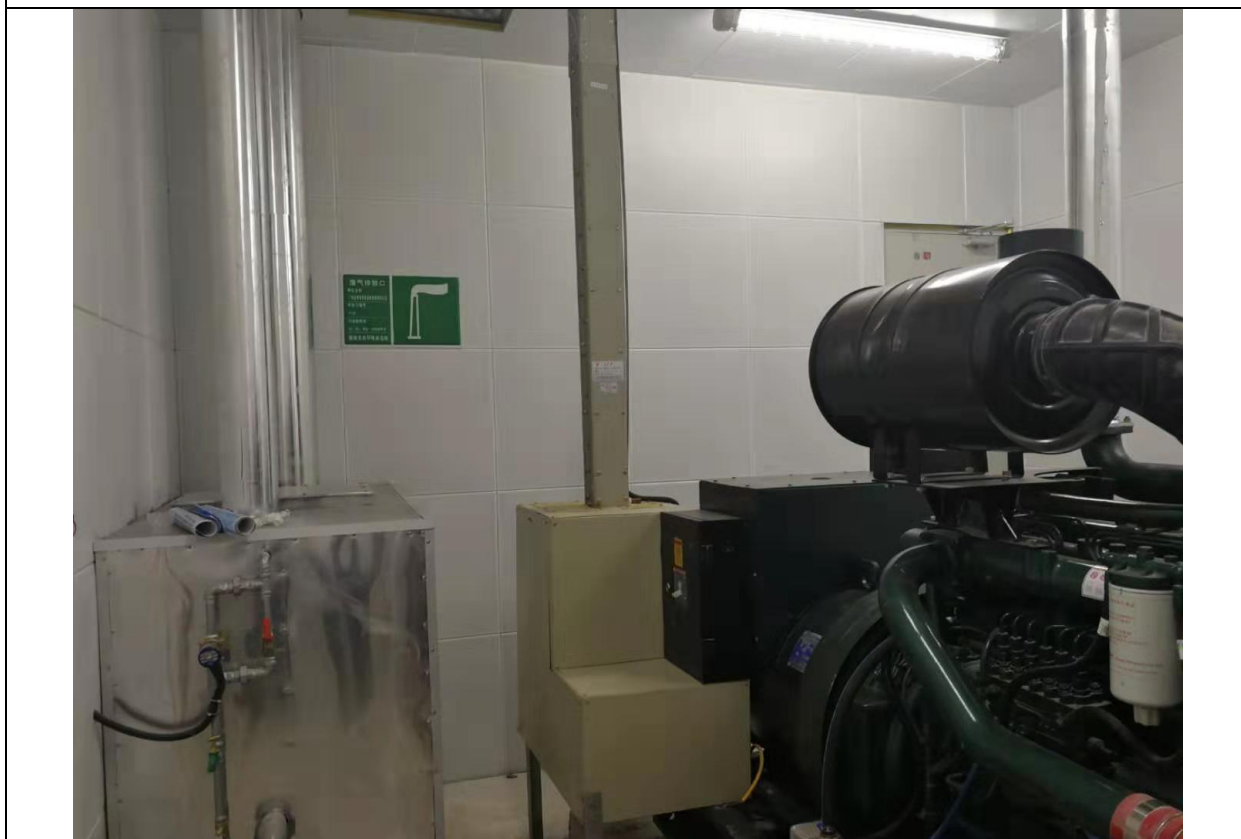
废气排放口：气-01（远照）
