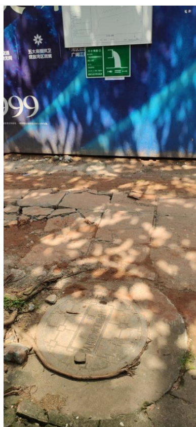
污水排放口：水-01（远照）
