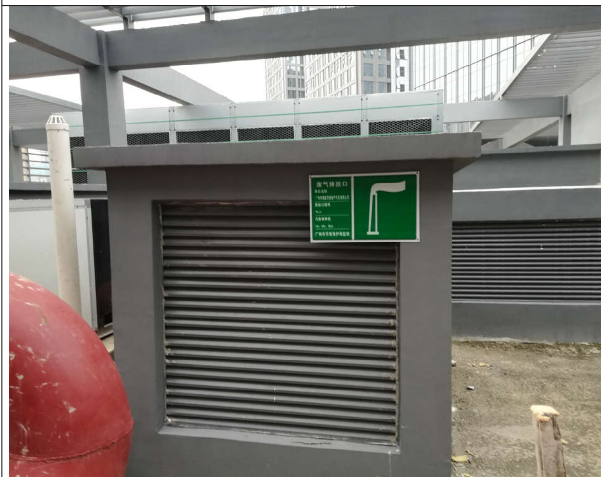
发电机尾气排放口：气-12（远照）
