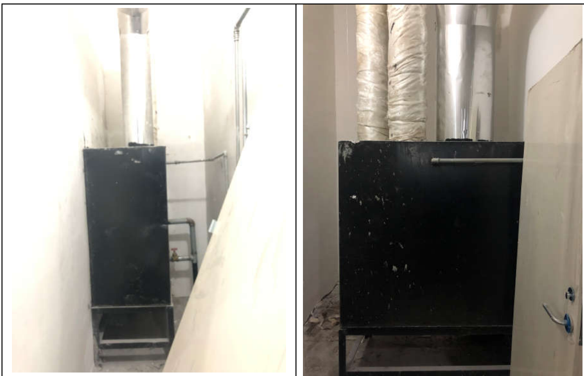
发电机水喷淋设施
