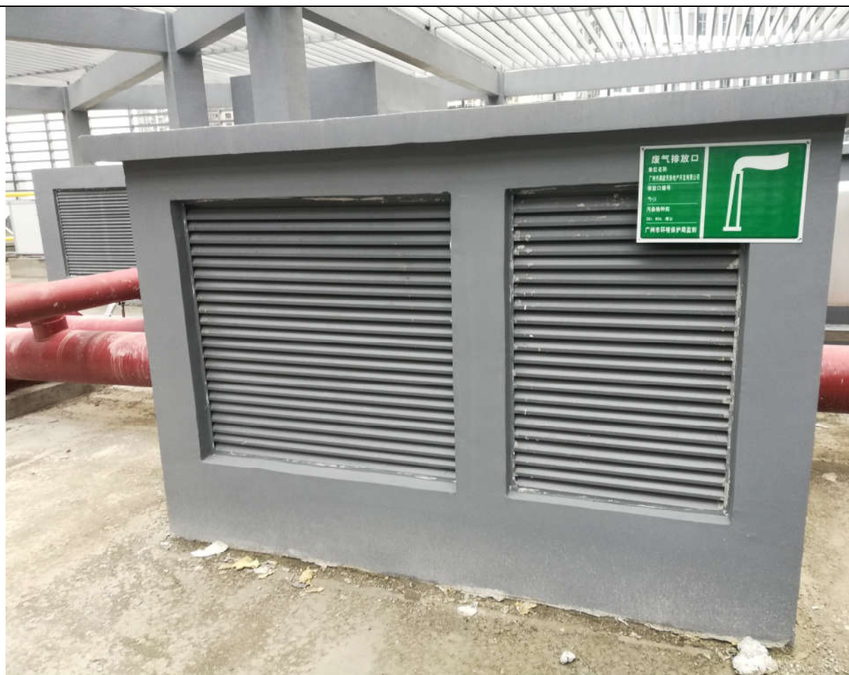
发电机尾气排放口：气-13（远照）
