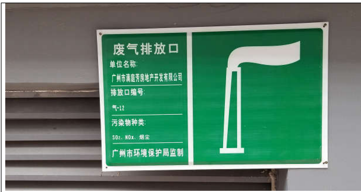
发电机尾气排放口：气-12（近照）
