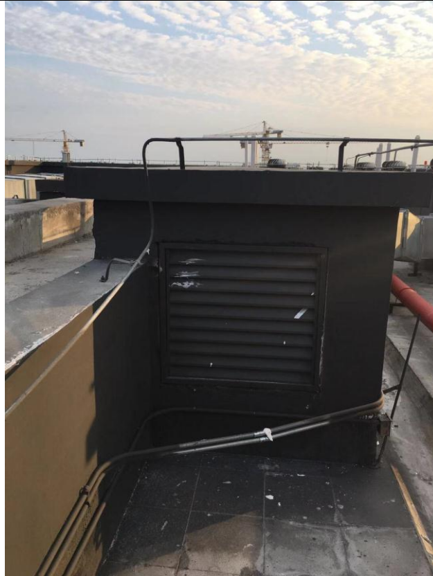
发电机尾气排放口
