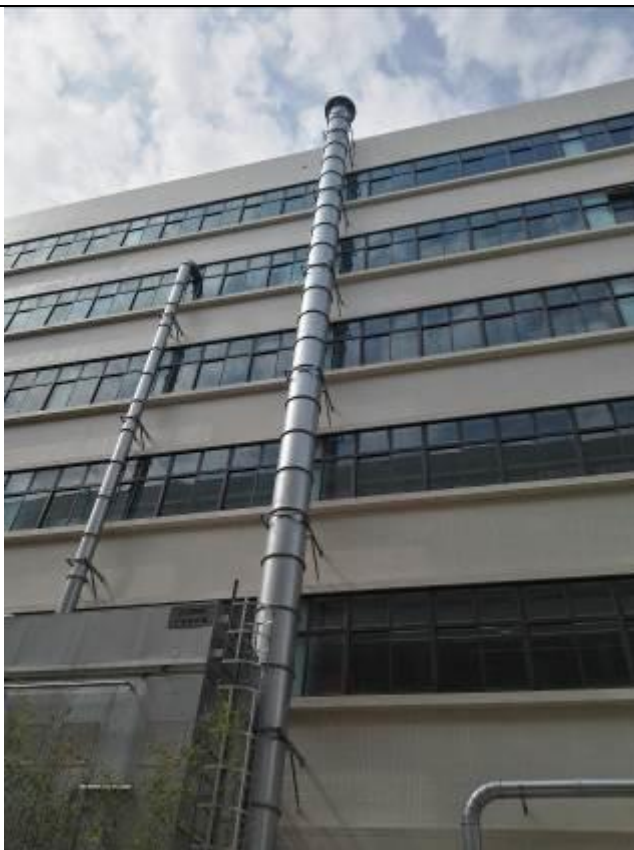
粉尘废气处理：布袋除尘器与排气筒
