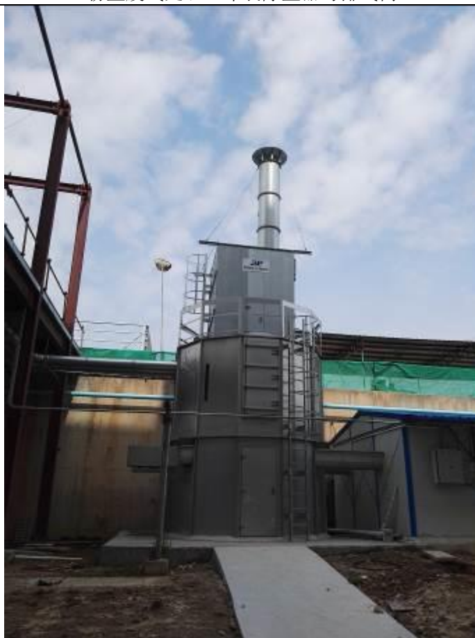
粉尘废气处理：布袋除尘器与排气筒
