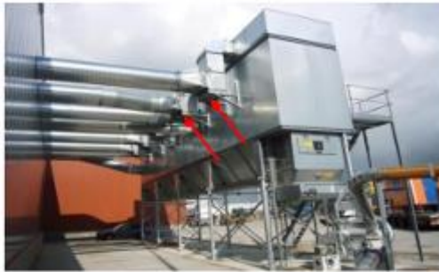
暖风回排系统 Return clean air system
