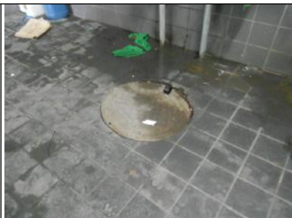
隔油隔渣处理池
