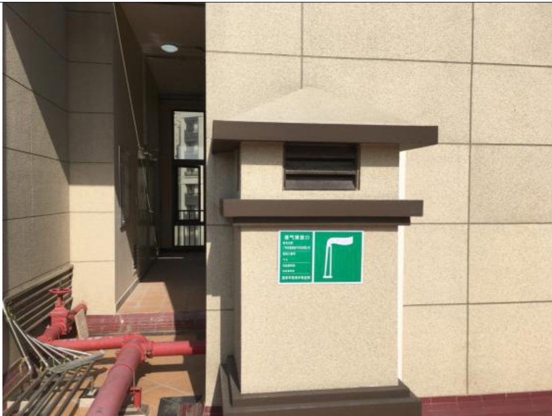
发电机尾气排放口：气-01（远照）
